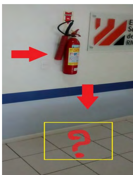
Extintor sem a sinalização adequada
