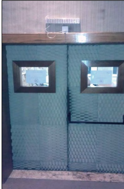
Porta do auditório com barra anti-pânico e a luminária de emergência.
