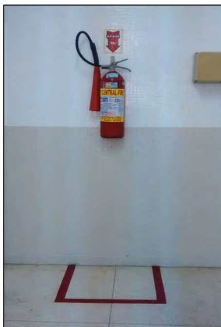
Extintor bem sinalizado
