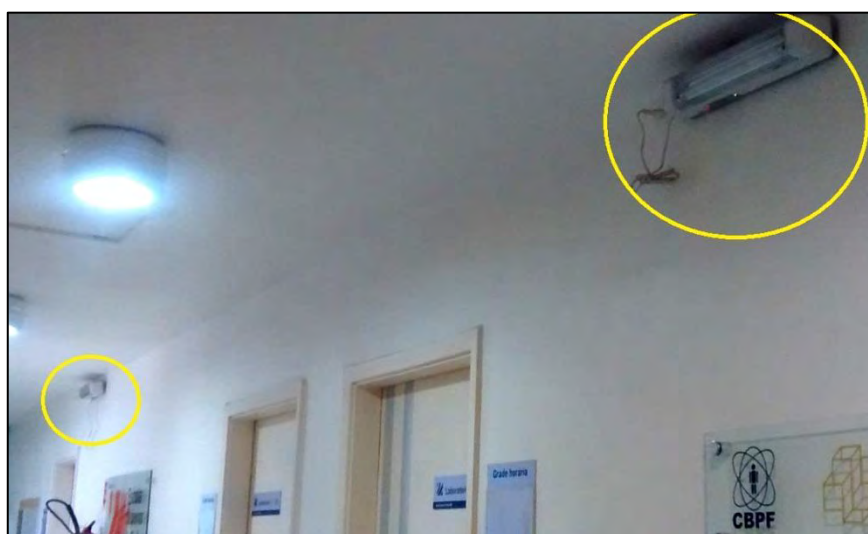
Luminárias de emergência
