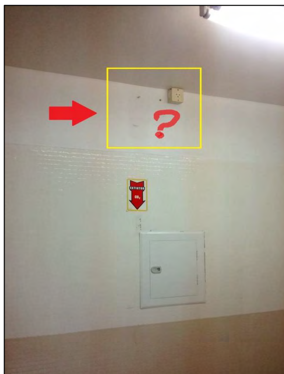
Não possui luminária de emergência
