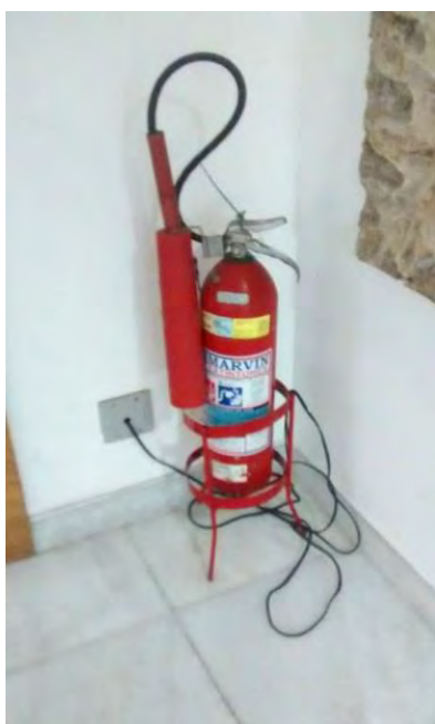
Extintor sem sinalização adequada.
