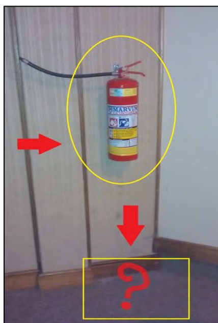
Extintor com falta de sinalização
