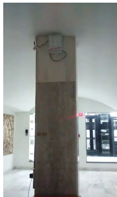
Luminária de emergência.
