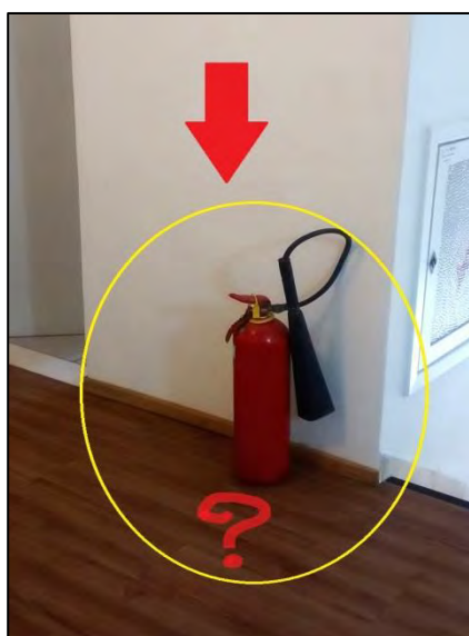
Extintor sem a sinalização adequada
